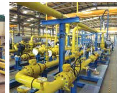
LNG GRS station Malta
